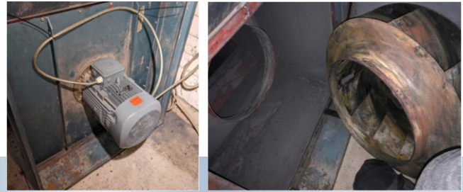
Bild 2/3) Links der Antriebsmotor für das Lüfterrad im eingebauten Zustand. Rechts das Lüfterrad montiert auf der Antriebswelle des Motors.
